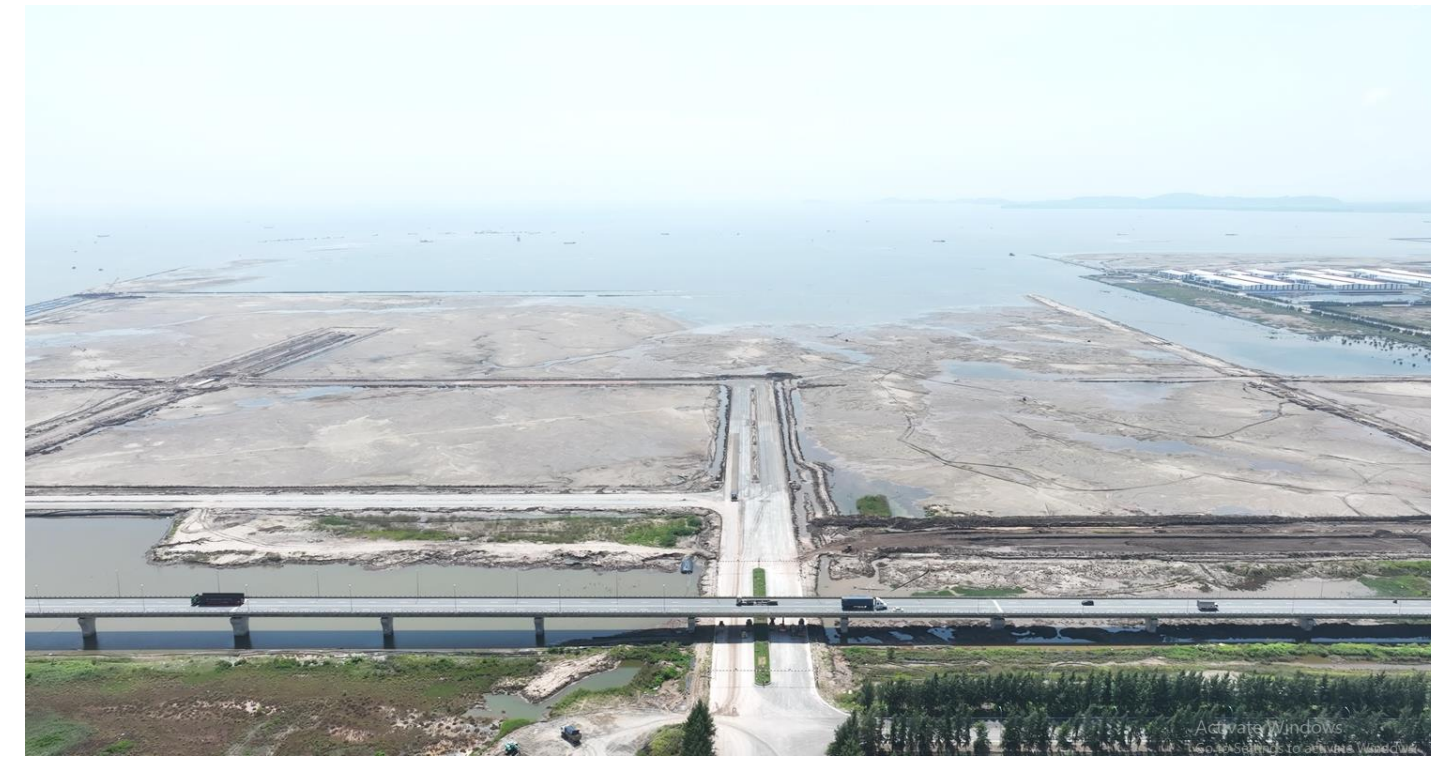
Khu vực 280 ha tiếp theo của giai đoạn 2 đang được tích cực san lấp và làm hạ tầng để mở rộng quỹ đất
